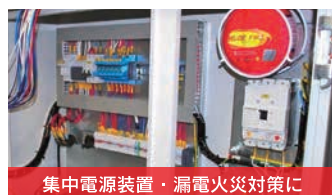
集中電源装置・漏電火災対策に
